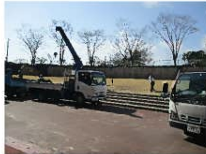
エアレーション
