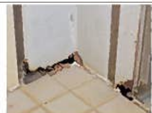
施設の老朽化（トイレ）
