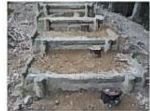
園路内の段差
