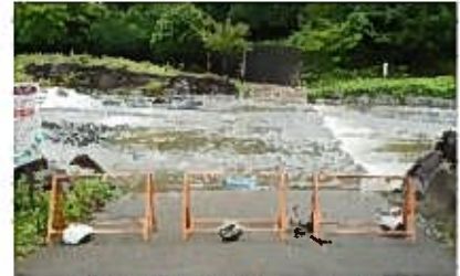
「沢の橋」の通行止め措置
