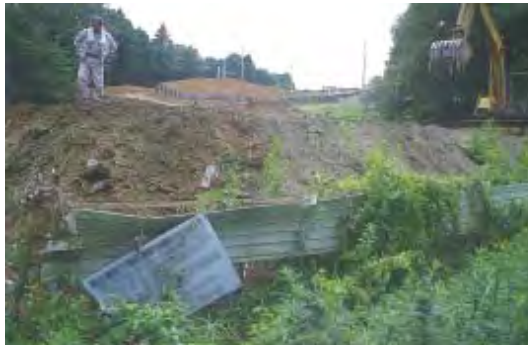
残土や産廃で埋め立てられる谷津田
