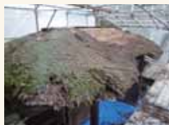
修復前の屋根は原形を留めないうま腐朽が進行していました
