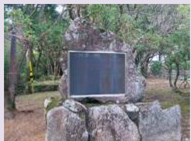
ベルツの碑は日常清掃時に石の 劣化の確認と碑面の汚れを点検
