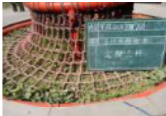
大型複合遊具点検①
