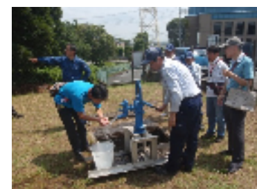
防災設備の作動確認
