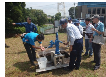
防災設備の作動確認
