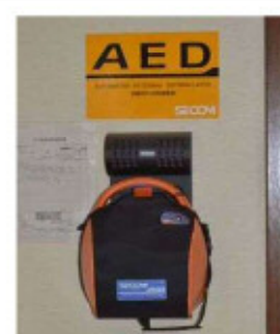
パークセンター内に設置してあるAED
