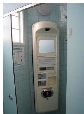
下飯田遊水地トイレ・シャワー棟内温水シャワー設置運営
