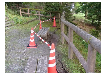
大雨により亀裂が入った「草花の丘」 緊急巡視により早急な保全措置が可能
