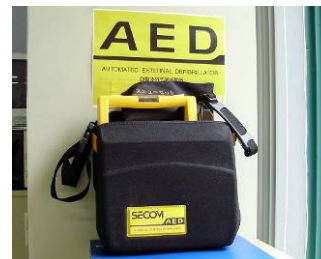
湖畔展望館内に設置したAED
