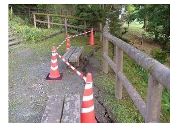
大雨により亀裂が入った「草花の丘」 緊急巡視により早急な保全措置が可能
