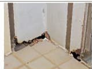
施設の老朽化（トイレ）
