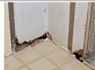
施設の老朽化（トイレ）
