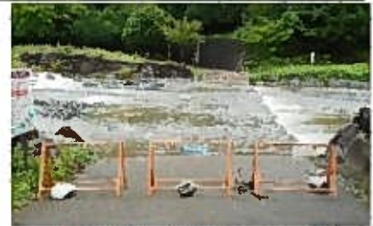
「沢の橋」の通行止め措置
