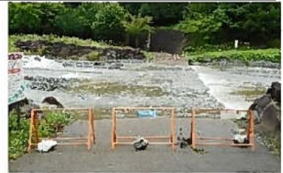
「沢の橋」の通行止め措置
