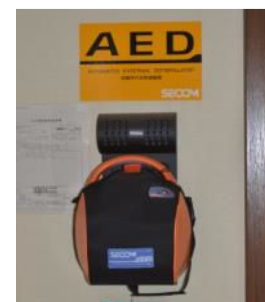
パークセンター内に設置してあるAED
