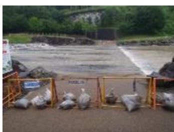
河川への立入禁止措置
